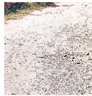
महेंद्रगढ़। जर्जर अवस्था में सड़क।
